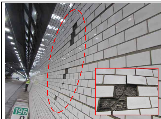
타일들뜸 및 탈락(Span 5)
